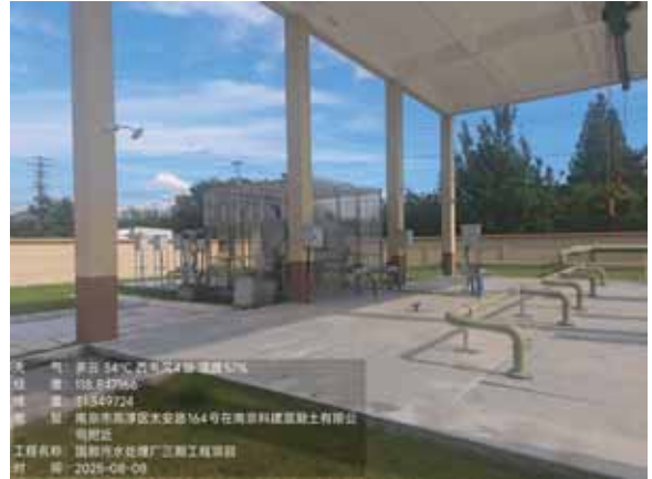
粗格栅及提升泵房
